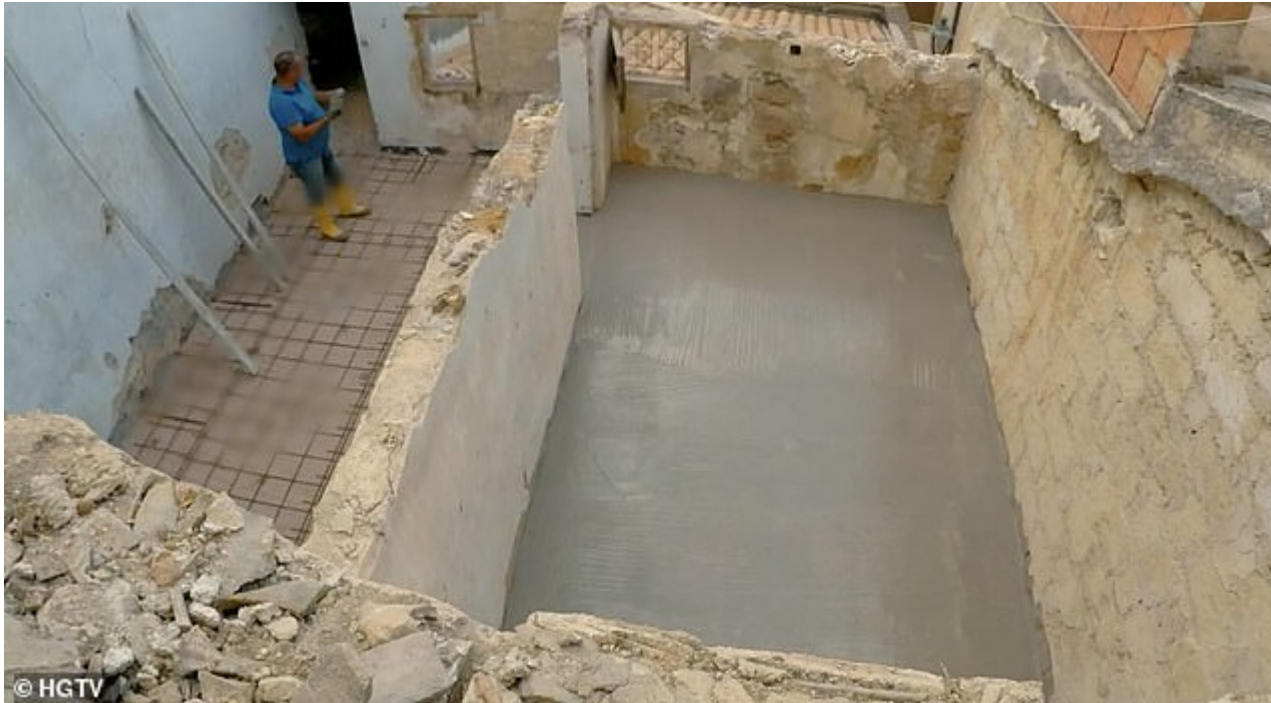
Η οροφή του σπιτιού είχε καταστραφεί τελείως και χρειάστηκε νέα, όπως και καινούρια πατώματα
